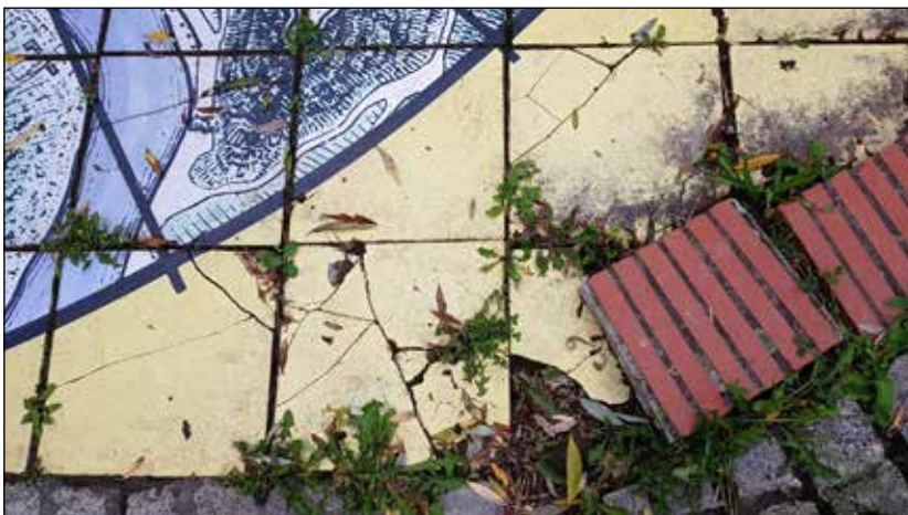
Abb. 5: Detailaufnahmen der Schäden an der Umrandung und der Risse in den Randfliesen
