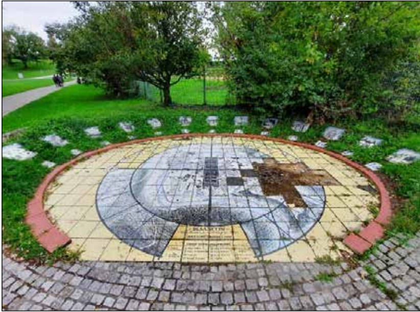
Abb. 4: Sachstand im Oktober 2022: Großflächige Ablösung der Kacheln im rechten Zifferblatt-Bereich. Weitere Schäden an der Umrandung. Die bereits vor 3 Jahren vorhandene Teer-Split-Reparatur ist im Original erhalten.
